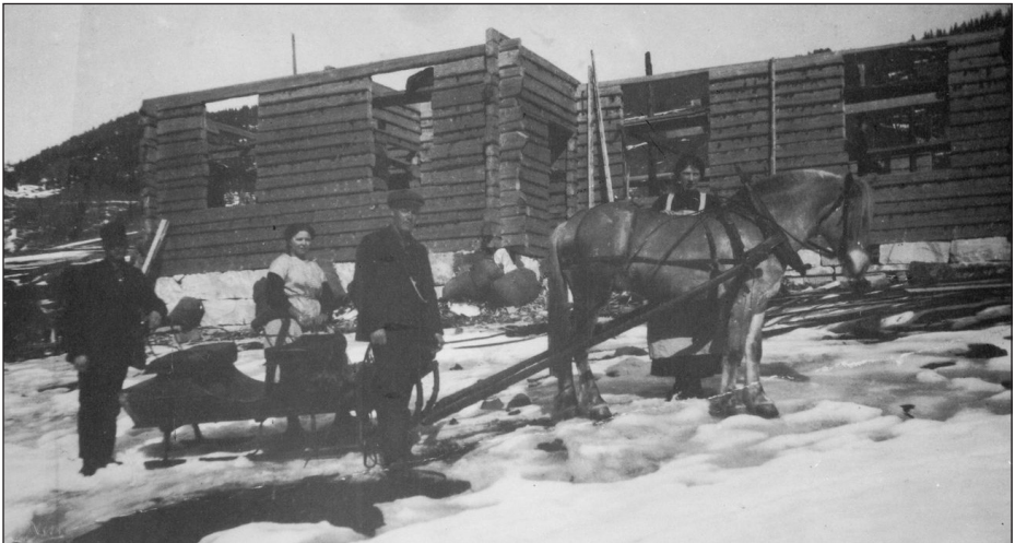
Det tok tid å komme i gang med arbeidet på Bergtun, men kanskje hjelpte det med eit lesarinnlegg. Her er i alle fall bygginga komme langt
